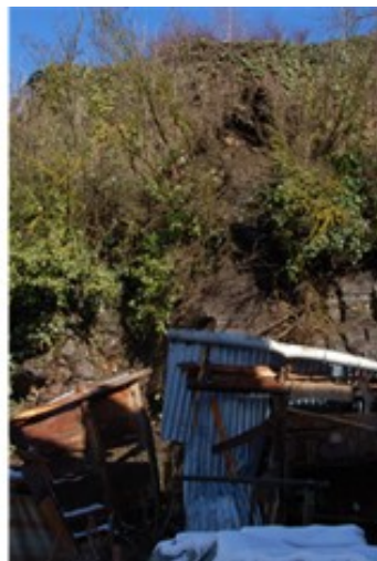
Chute de blocs, rue des Cascades en janvier 2009
